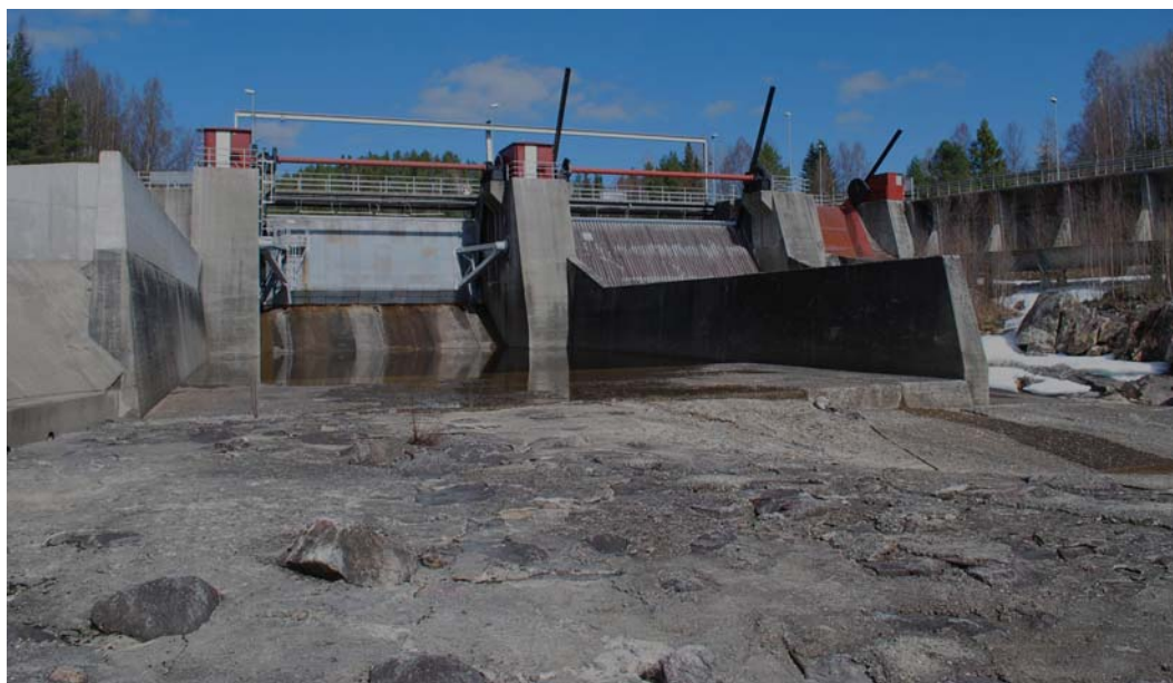
Figur 27. Edsele kraftverk sett nedifrån 2011.
